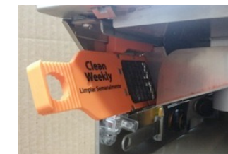
Clean fan filters.
